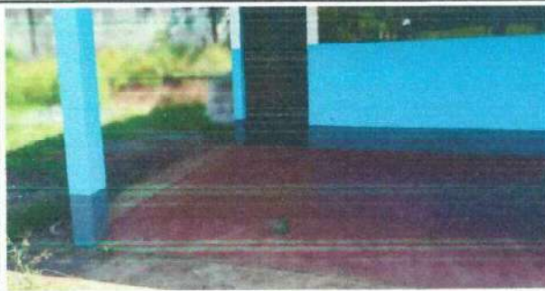
Foto 2: Aula y corredor de Segundo Primaria, la torta de concreto se encuentra dañada por lo que será sustituida por piso cerámico.
