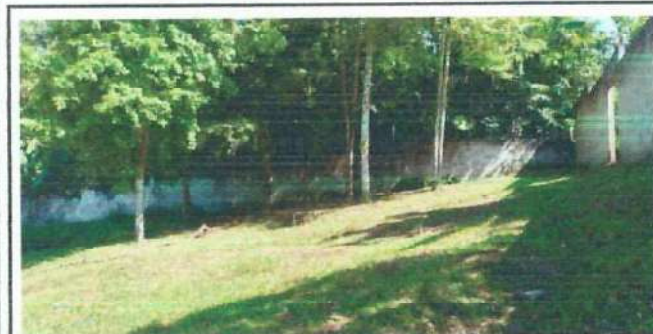
Foto 11: Lado Noreste faltan 3 filas de block y solera.
